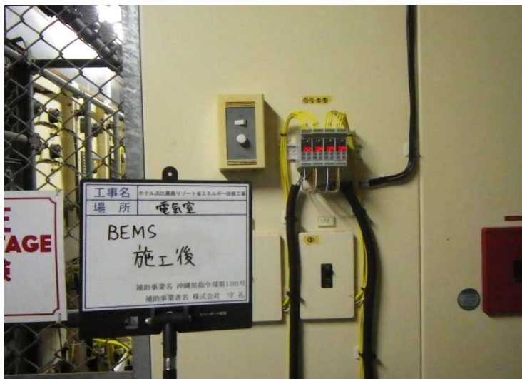
エネルギー管理システム電気室(BEMS)
